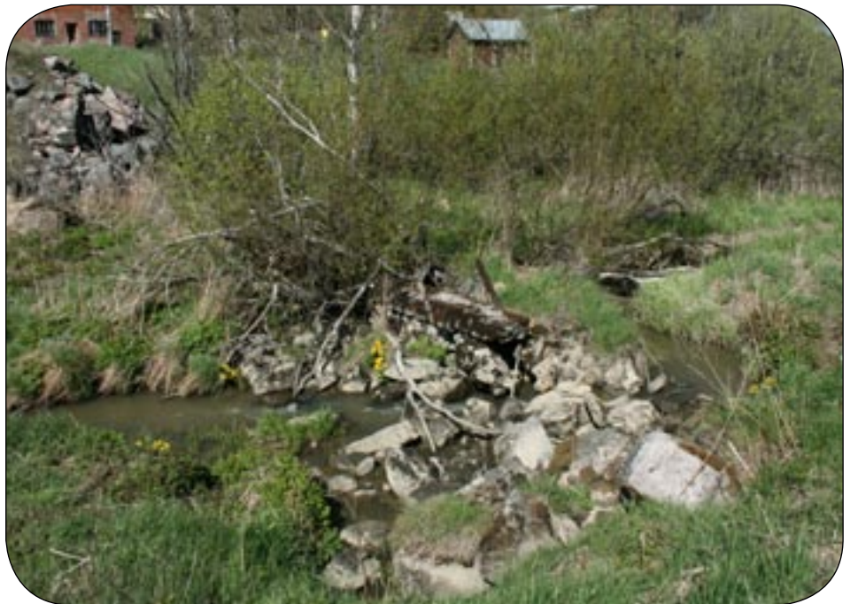
Kuva 47. Storträskin pu- rossa oleva pato on sortunut, eikä enää muodosta vaellusestettä. Padonkohdalla ja padon alapuolel- la on kuitenkin tarvetta kalata- loudellisille kun- nostustoimille.
